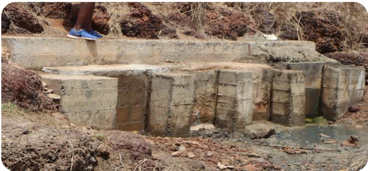
Dégradation des valves, Dorse, Biombo
